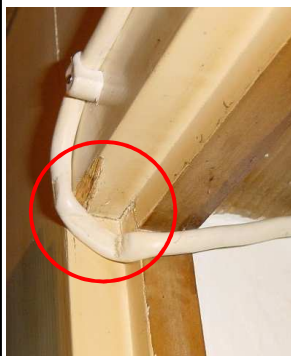
Gequetschtes Kabel bei Türe, Isolationsschaden, eingedrückte Leiter, Brandgefahr
