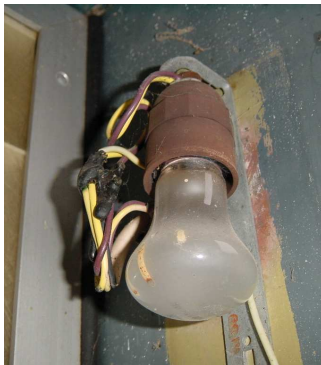
Laienhafter Lampenanschluss, kein Berührungsschutz, keine Abdeckung
