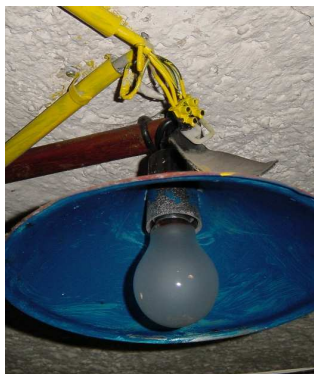
Offene Leiter beim Leuchtenanschluss, kein Berührungsschutz
