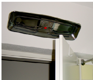
Heizstrahlermontage Abstand zu klein zur brennbaren Türe
