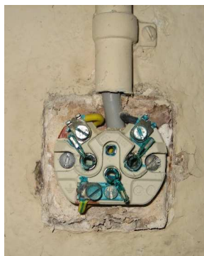
Korrodierte Steckdose, fehlende Abdeckung, kein Berührungsschutz
